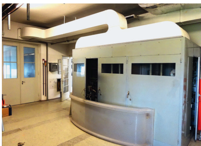
Abb. 10: Oben am Sender die mächtigen Abluftkanäle
